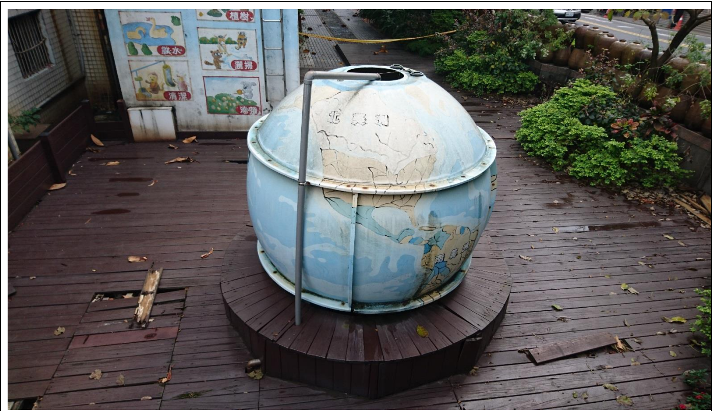
說明：改善前-底樑腐朽、大面積塌陷
