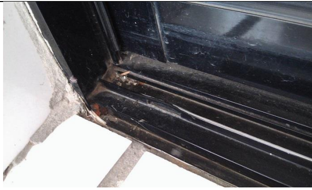
窗戶軌道變形
