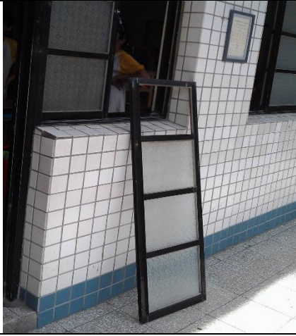
窗戶脫落情形
