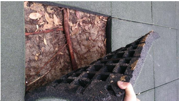
樹根盤據，造成鋪面突起
