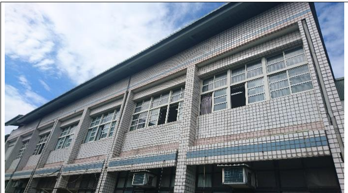
說明：改善前-和平樓窗戶西曬嚴重，無遮陽板
