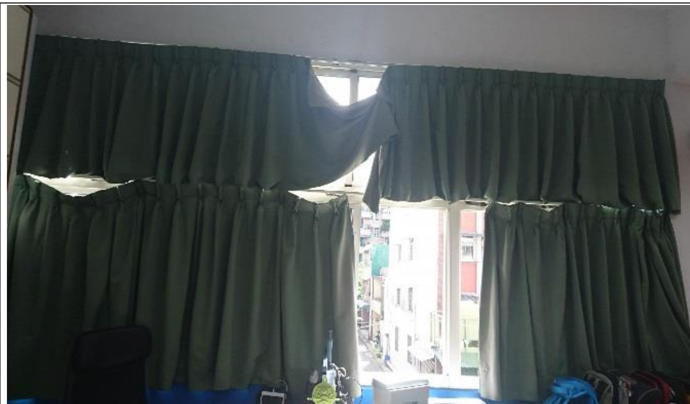
說明：改善前-教室窗簾軌道損壞
