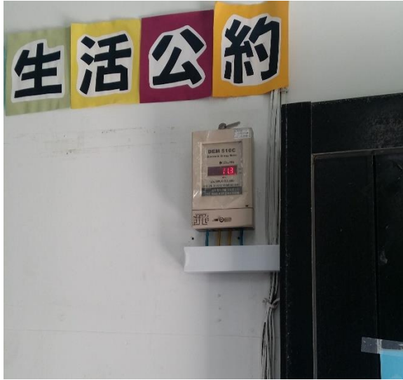
105 年 9 月五甲新設電表
